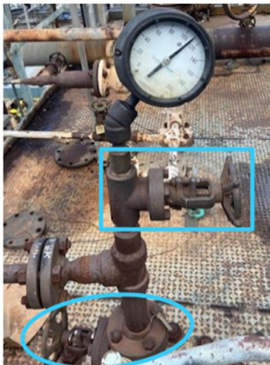
Figuur 1. Afsluiter ter isolatie van de manometer
