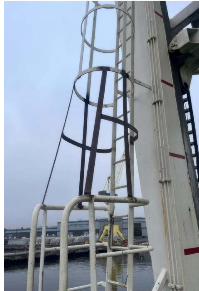
▼ Figuur 12: De figuur laat zien welke extra bescherming van het ongeval is toegevoegd tussen de reling van het platform en de beschermkooi van de ladders. (Bron: Wagenborg Shipping)
